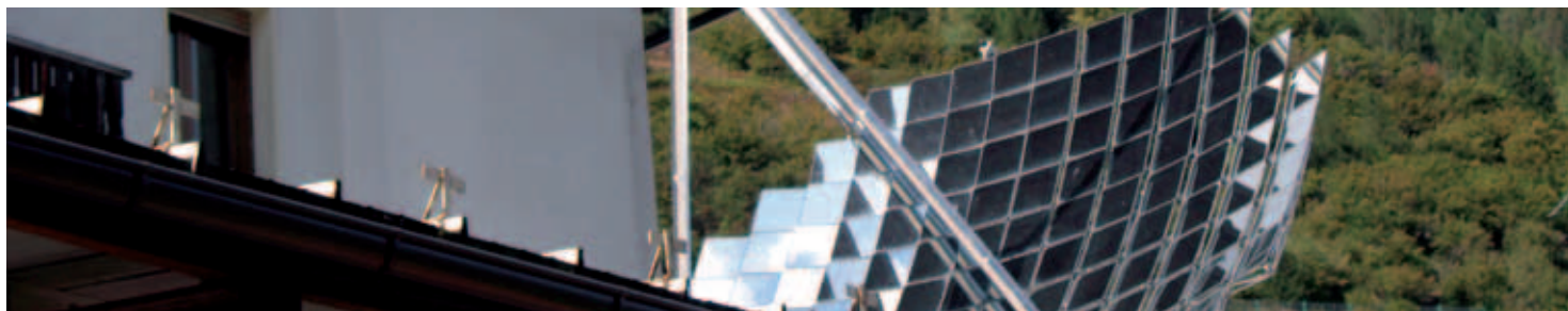
Impianto fotovoltaico a concentrazione, Comune di Fasano
