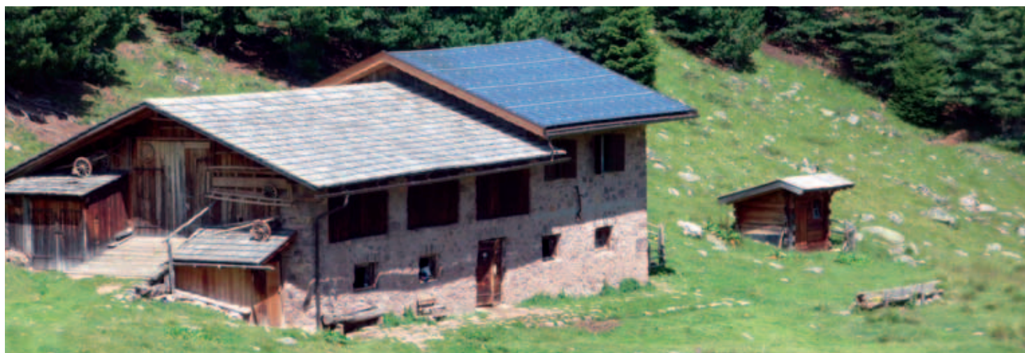
Impianto solare fotovoltaico su abitazione rurale in Alto Adige
