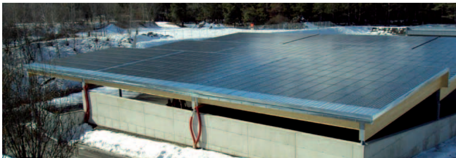
Impianto fotovoltaico azienda, Comune di Prato allo Stelvio
