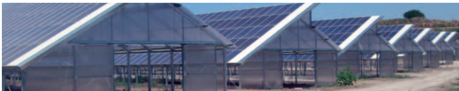
Impianti fotovoltaici su serra, Comune di Tarquinia
