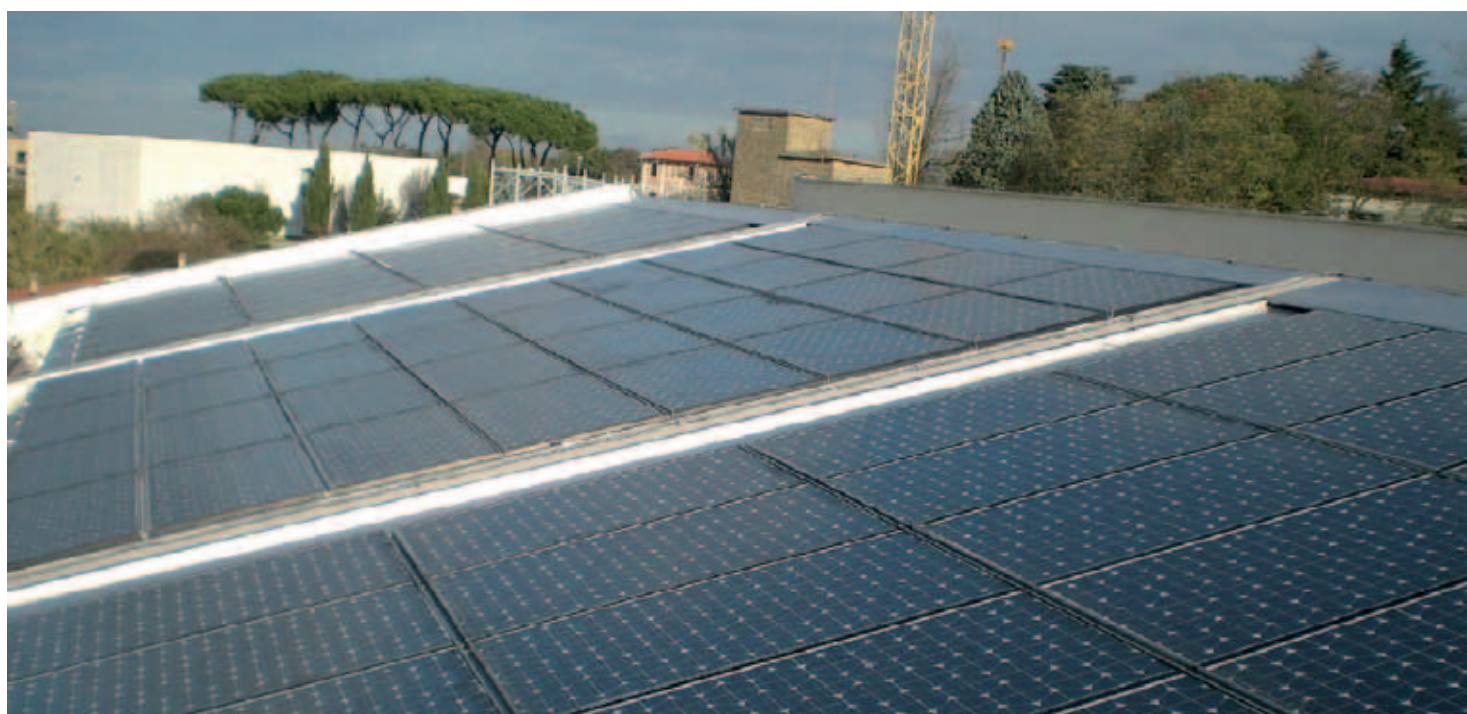
Impianto fotovoltaico Liceo Scientifico Piazzi, Comune di Morlupo, finanziato Provincia di Roma
