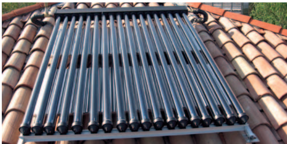
Impianto solare termico su tetto
