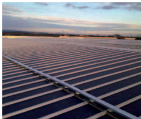
Impianto fotovoltaico su copertura azienda, Comune di Taranto
