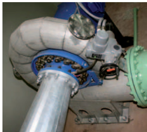
Turbina mini idroelettrica
